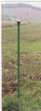
Oben: Eine an Ort und Stelle fertig installierte Verdampfersäule des Porocol-Systems.
